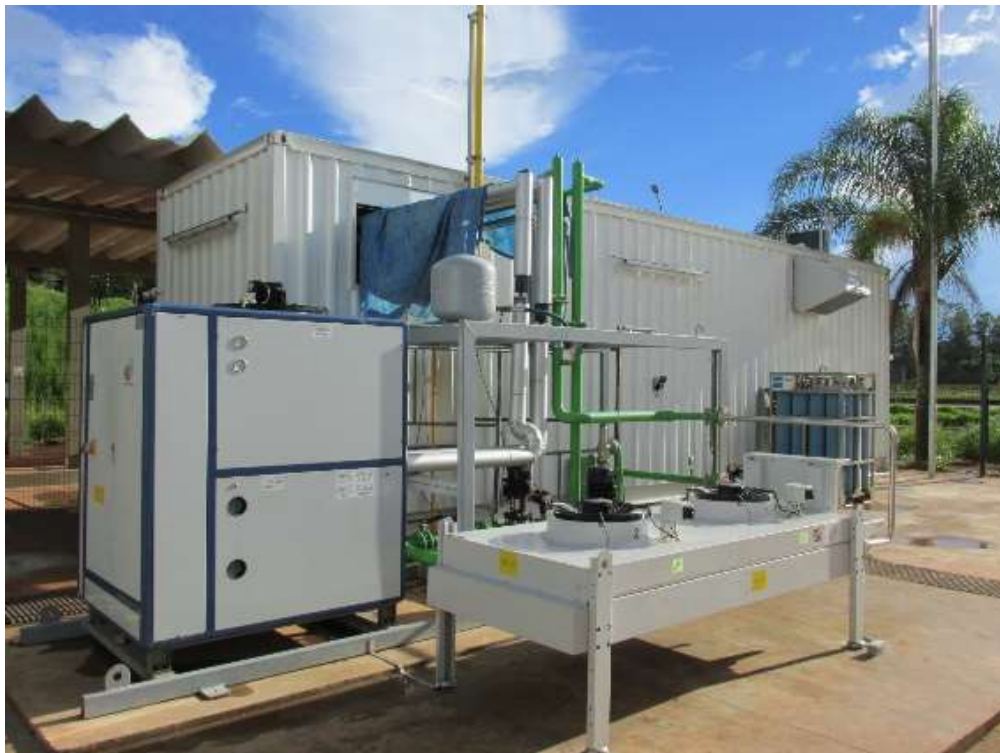
Trocador de calor para resfriamento do biogás
