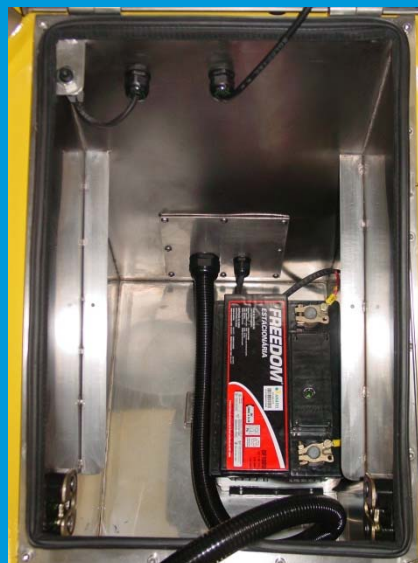
BATERIA PARA ARMAZENAMENTO DE ENERGIA
